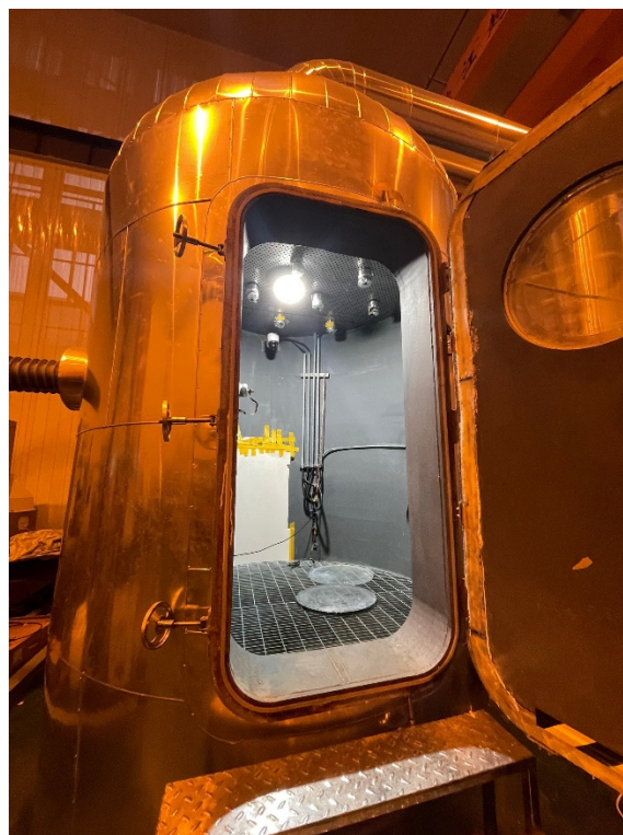
ภาพที่ 12 ห้องสำหรับสร้างสภาวะแวดล้อม เสมือนสำหรับทดสอบอุปกรณ์ไฟฟ้าแรงสูง
