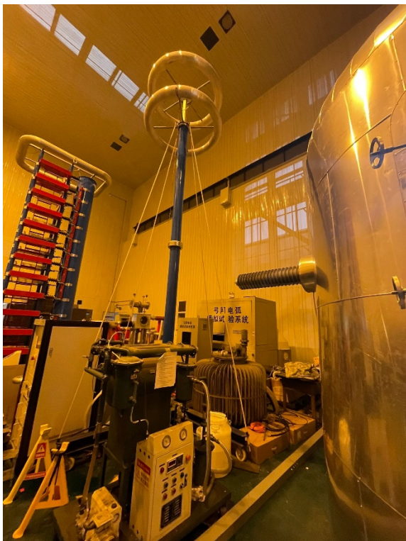
ภาพที่ 11 อุปกรณ์กำเนิดไฟฟ้าแรงดันสูง
